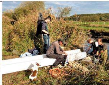
Mario Ferreira, menuisier à Clamecy, dirige la manœuvre pour installer les bastaings de 12 m de long !
